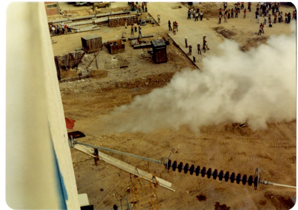
INICIACION SOPLADO DE CALDERA
