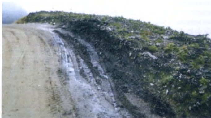
Foto. Adecuación de bermas por alteración de apertura de vías. Nótese la siembra realizada sobre ésta como recuperación visual y paisajística (Cortesía David Buitrago Salomón).
