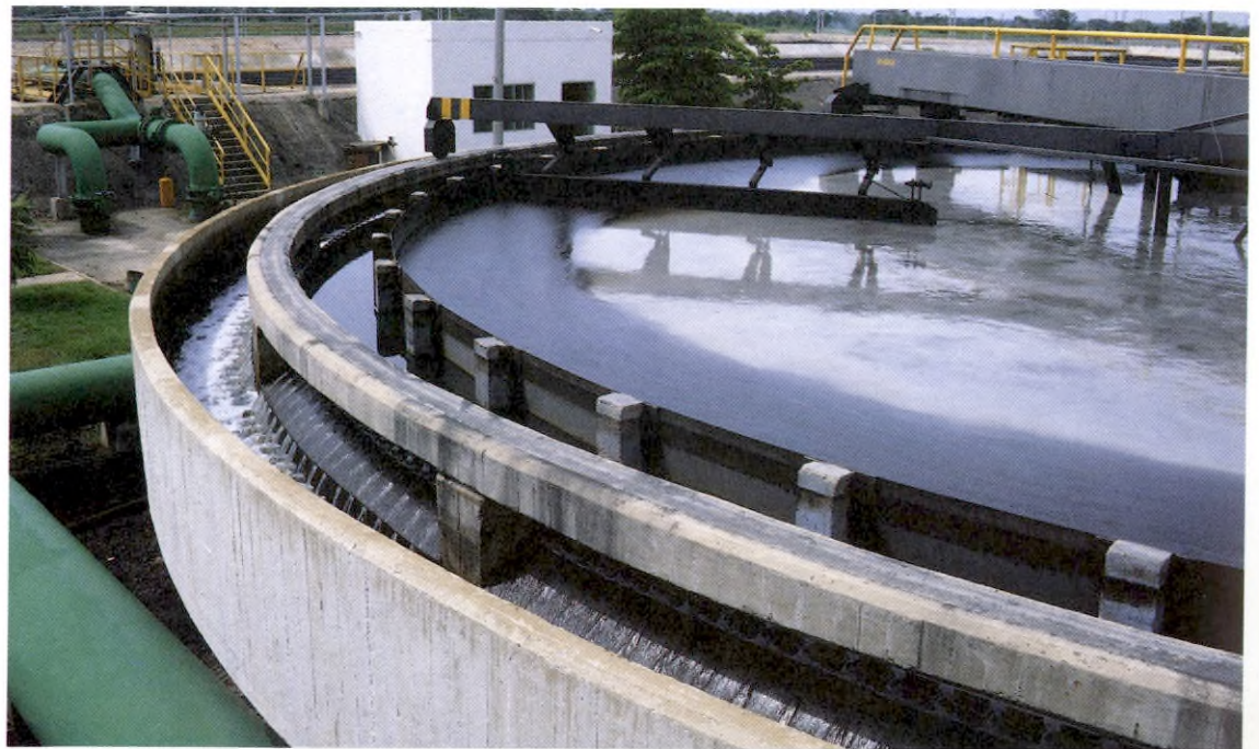
Complejo Industrial de Barrancabermeja Clarificador Planta de tratamiento de aguas residuales
