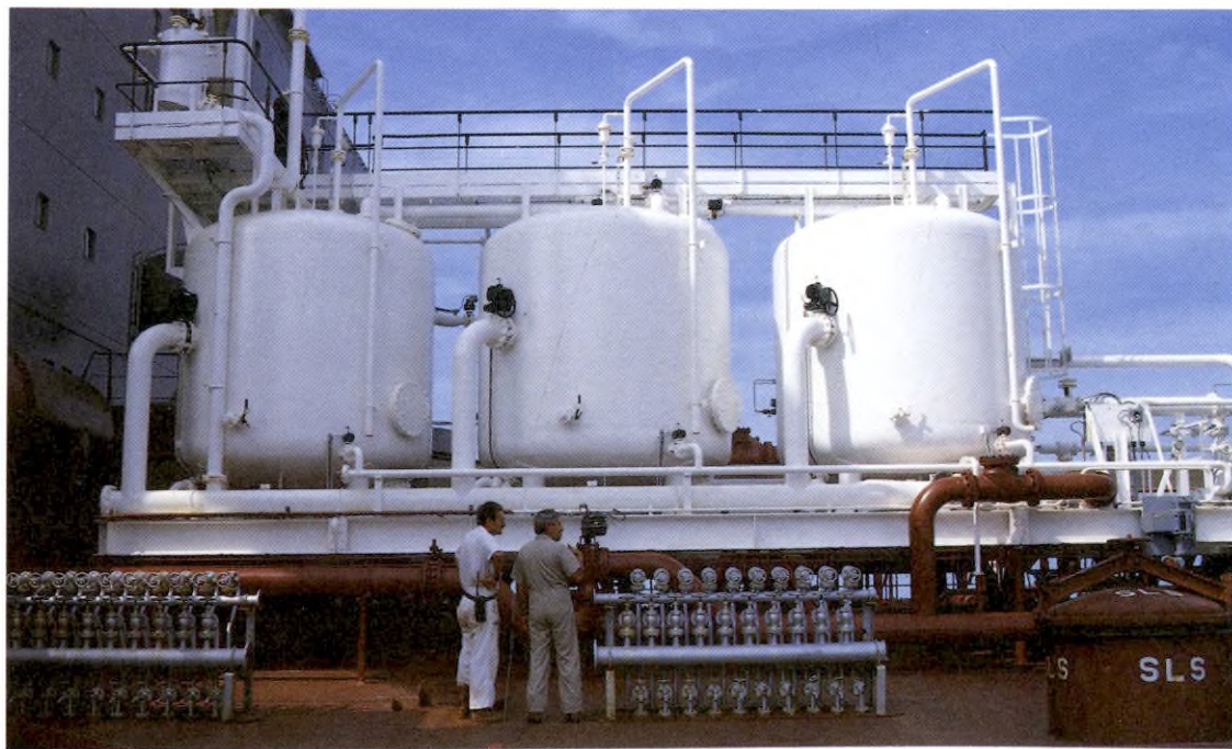
Distrito Caño Limón - Coveñas Planta de Tratamiento de lastre de la Unidad F.S.U.
