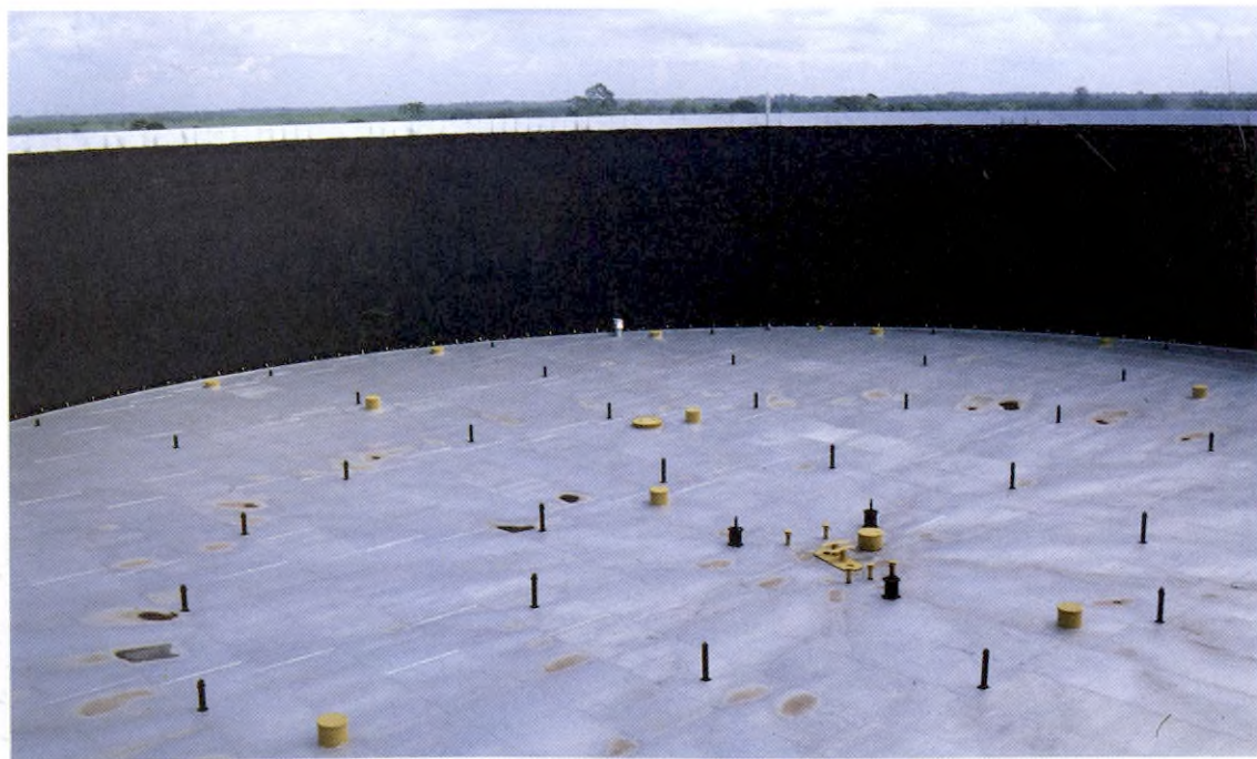
Complejo Industrial de Barrancabermeja Techo flotante instalado en una tanque de almacenamiento
