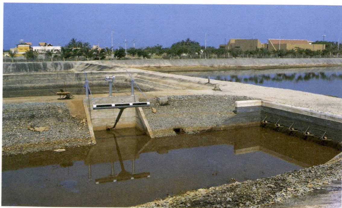
Distrito de Oleoductos Terminal pozos colorados Sistema de tratamiento de aguas aceitosas
