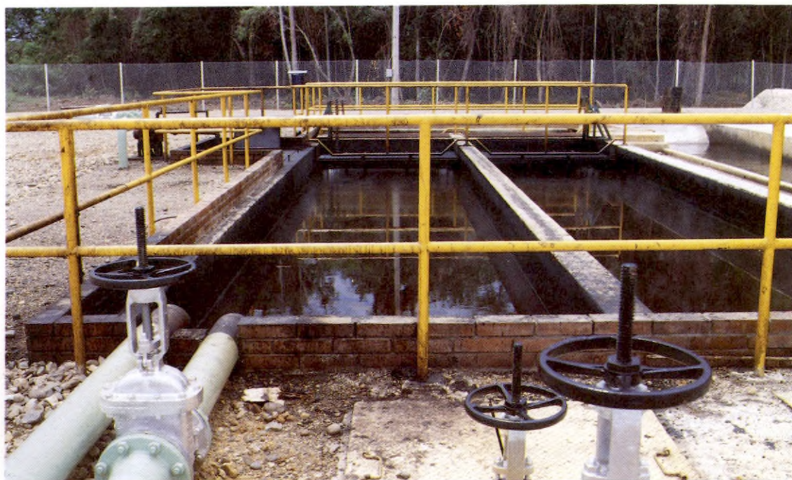
Campo de Apiay Separador A.P.I.
