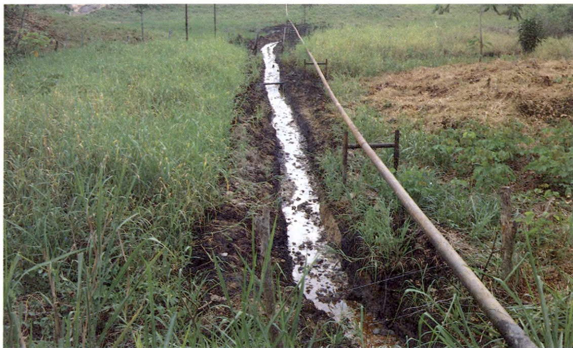
Distrito de Producción El Centro Obras de protección contra derrames de hidrocarburos
