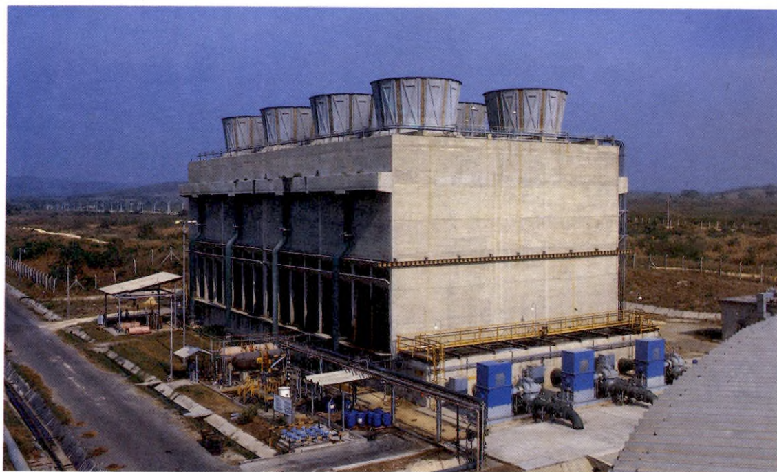
Distrito de Cartagena Torre para tratamiento de agua de enfriamiento
