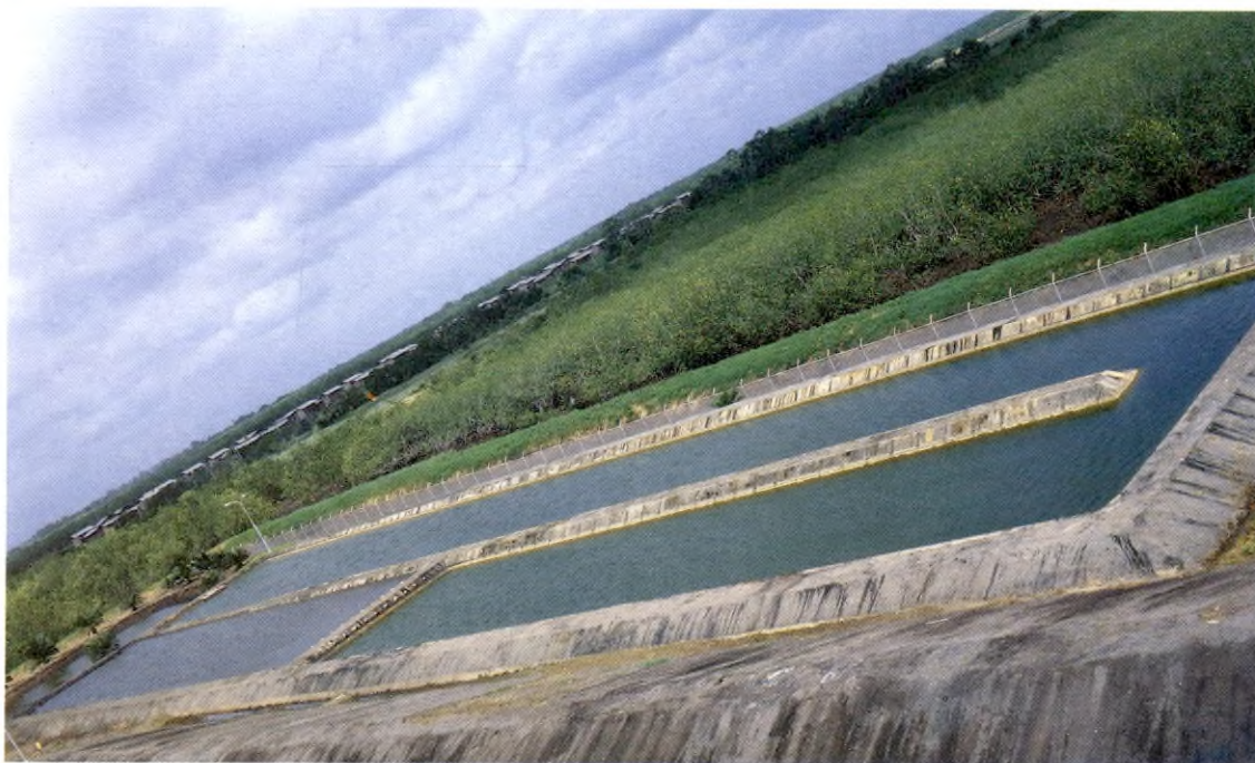
Distrito Sur - Tumaco Sistema de tratamiento de aguas aceitosas
