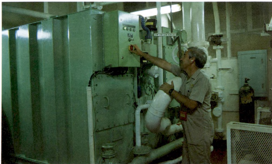
Distrito Caño Limón - Coveñas Tratamiento de aguas residuales domésticas en la Unidad F.S.U.
