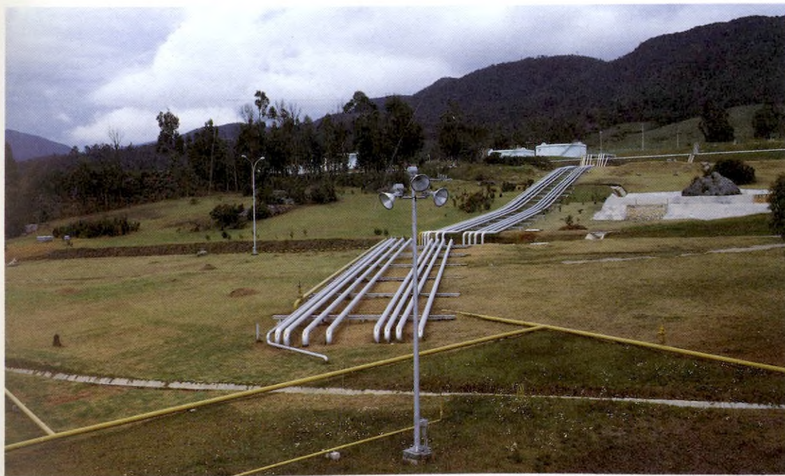
Distrito de Oleoductos - Terminal de la Sabana (Facatativá) Modelo de planificación ambiental
