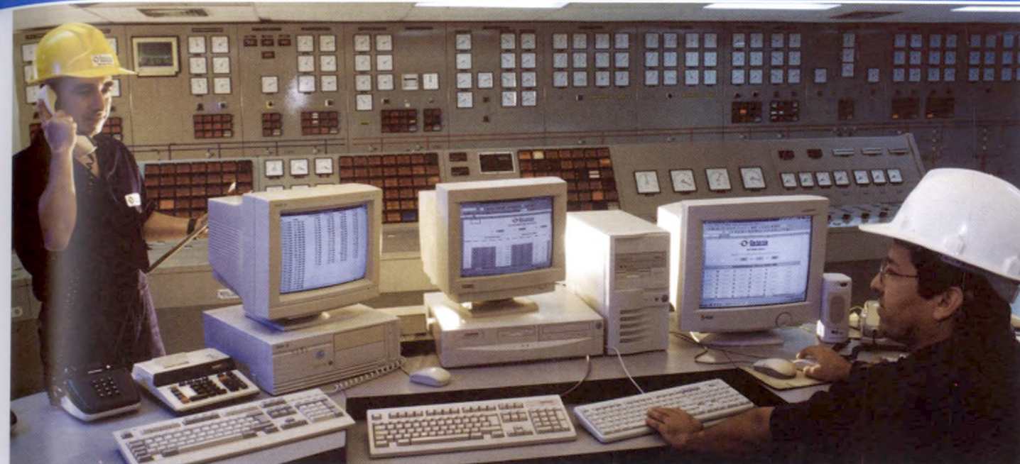
Sala de Control
