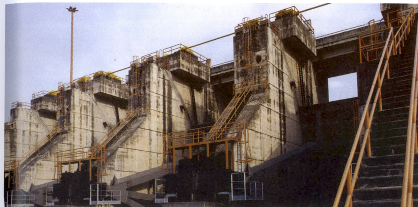
Panorámica Compuertas de Vertederos
