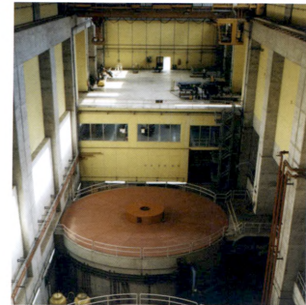
Casa de Máquinas
