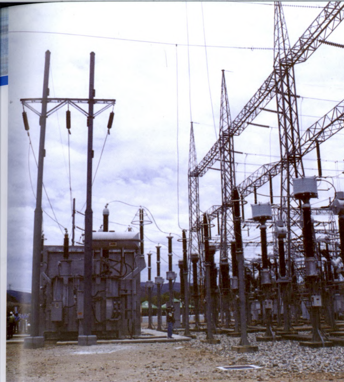
Nuevo Banco de Transformación y Subestación de Interconexión
