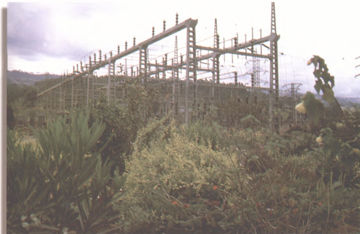
Subestación Eléctrica Termopaipa
