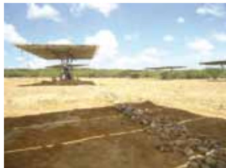
Foto. Seguidor solar instalado en Nazareth – Guajira. Diciembre de 2011 IPSE
