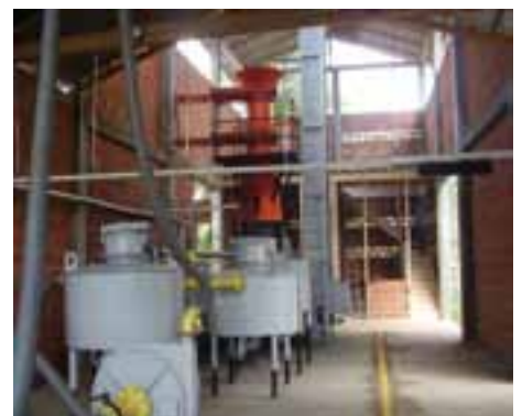
Foto. Gasificador de residuos de madera instalado en El Totumo – Necoclí Antioquia. Noviembre de 2008. IPSE
