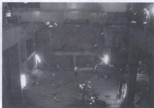
Proyecto Amoyá. Casa de Máquinas y Puente Grúa. Fuente: ISAGEN.
