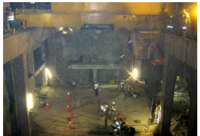
Proyecto Amoyá. Casa de Máquinas y Puente Grúa. Fuente: ISAGEN.
