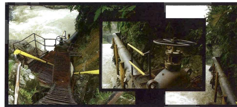
Figura 4-14. Tubería de conducción.
