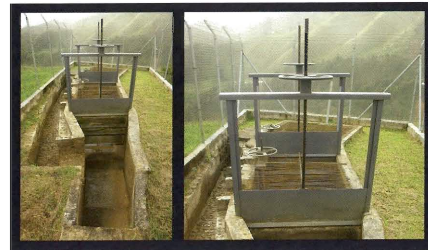
Figura 4-3. Tanque de carga.
