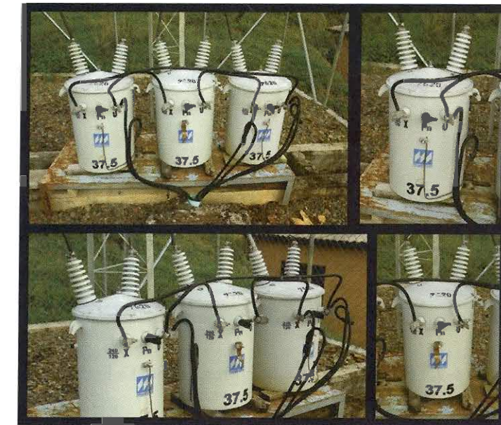
Figura 4-8. Banco de transformadores de la subestación microcentral La Encarnación.
