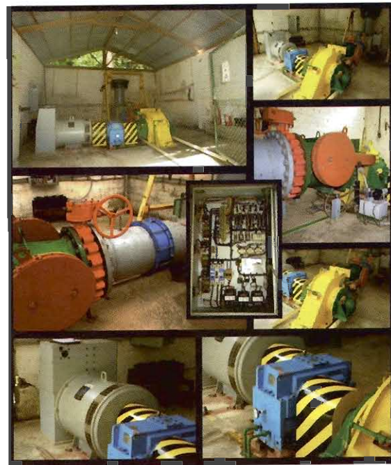
Figura 4-16. Casa de máquinas.
