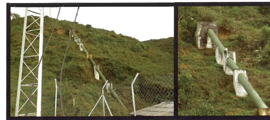
Figura 4-4. Tubería a presión.
