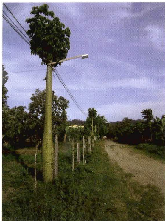
Figura 4-1. Instalaciones ilegales de energía eléctrica en vereda Nueva Pampa.
