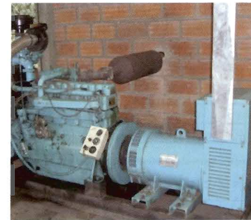
Figura 4-15. Motor generador de energía eléctrica.
