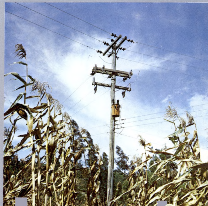
Plan Nacional de Electrificación Rural en el Municipio de Cáqueza Departamento de Cundinamarca
