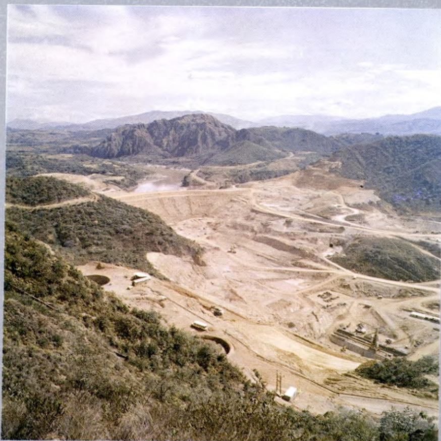
Vista Parcial de las obras en el Proyecto Hidroeléctrico de Betanía en el Departamento del Huila
