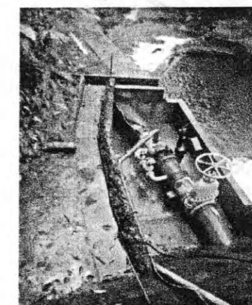
Foto No. 2 - Válvulas de Compuerta y Mariposa
