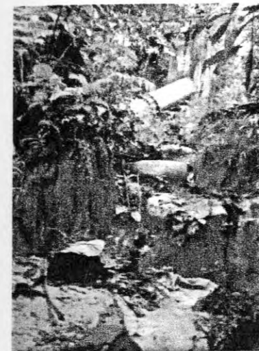
Erosión alrededor del apoyo
