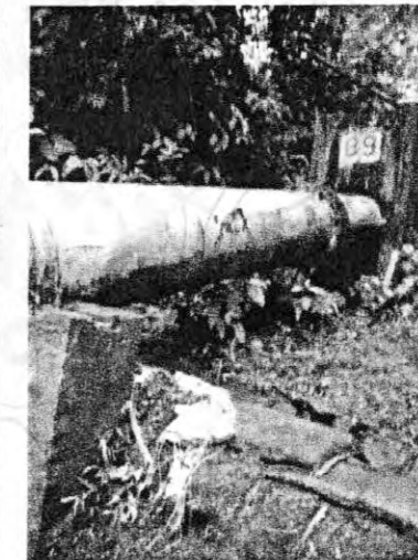
Canal en Sacocrete, la velocidad del agua lo desborda
