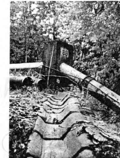
Obra de Manejo de Agua sin Protección
