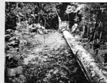
Obra de Manejo de Agua falta recubrimientos talud.
