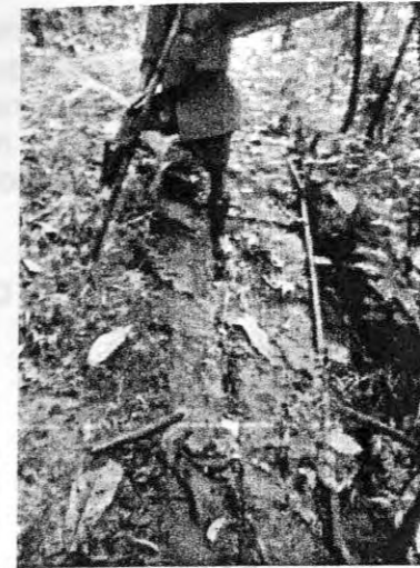
Cárcavas en la coronación de los trinchos
