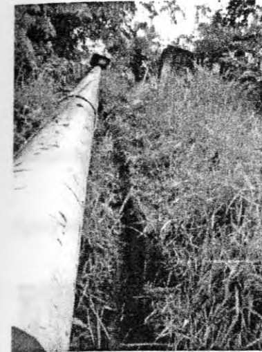
Canales sin la debida obra de entrega que genera erosión en la base
