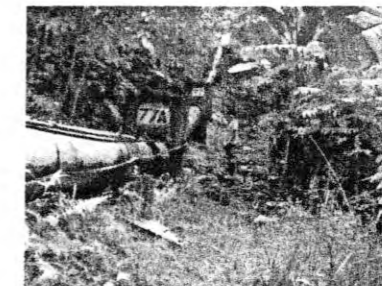
Obra de Manejo de Agua falta recubrimientos talud.
