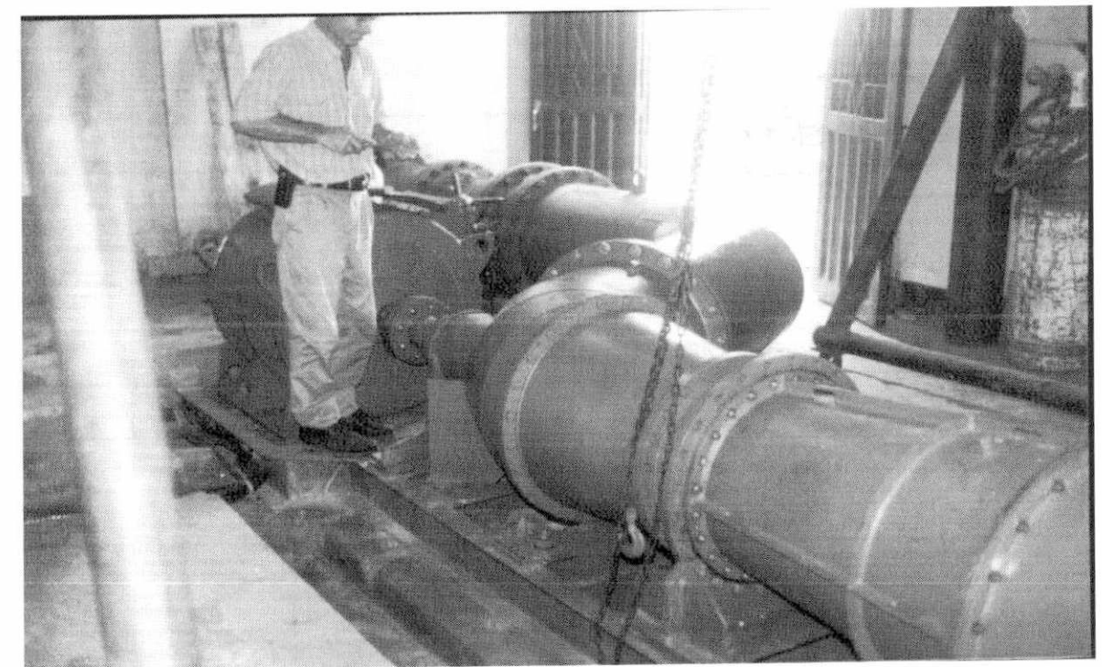
TURBINA KAPLAN POTENCIA = 70KW
