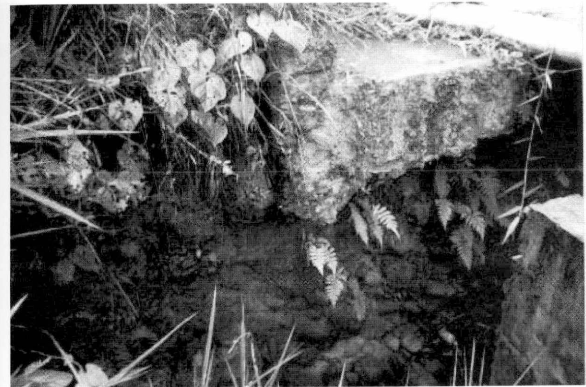
SOCAVACION DE ESTRUCTURAS Y SUELO POR FALTA DE PURGA DEL DESARENADOR
