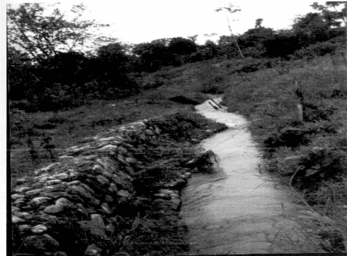
ESTRANGULAMIENTO DE LA SECCION DEL CANAL
