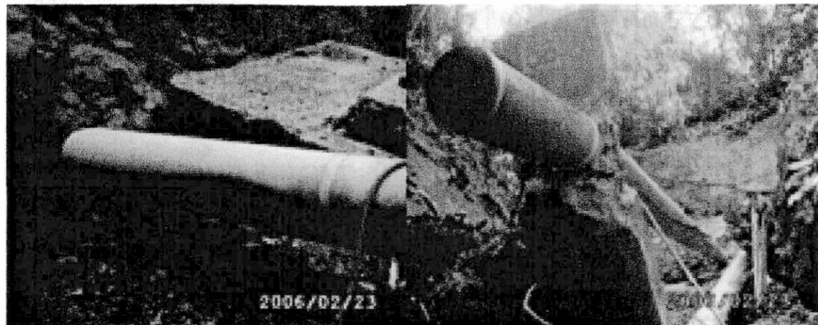
Tubería en sitio de derrumbe
