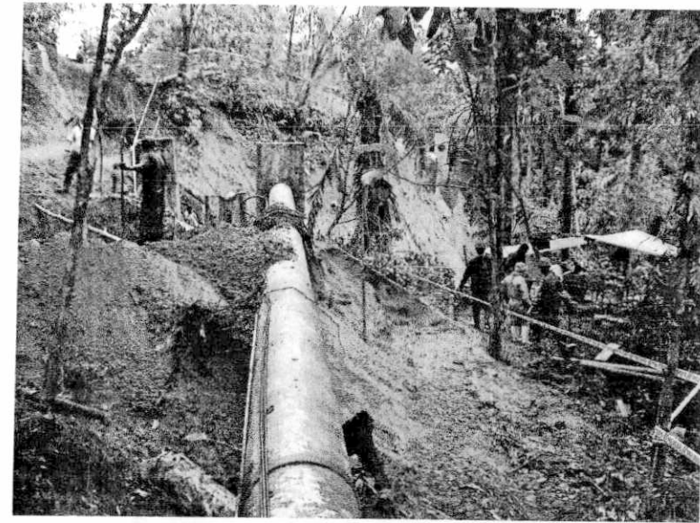
FOTOGRAFÍA No. 13. PCH BAHÍA SOLANO Trazado de la tubería – Se aprecia la corona del derrumbe
