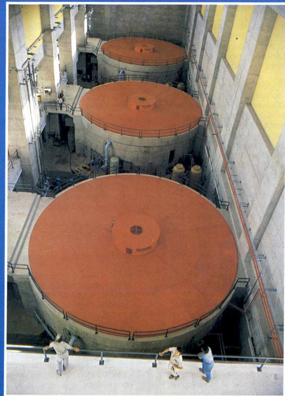
TURBINAS DEL PROYECTO HIDROELECTRICO DE BETANIA (HUILA).
