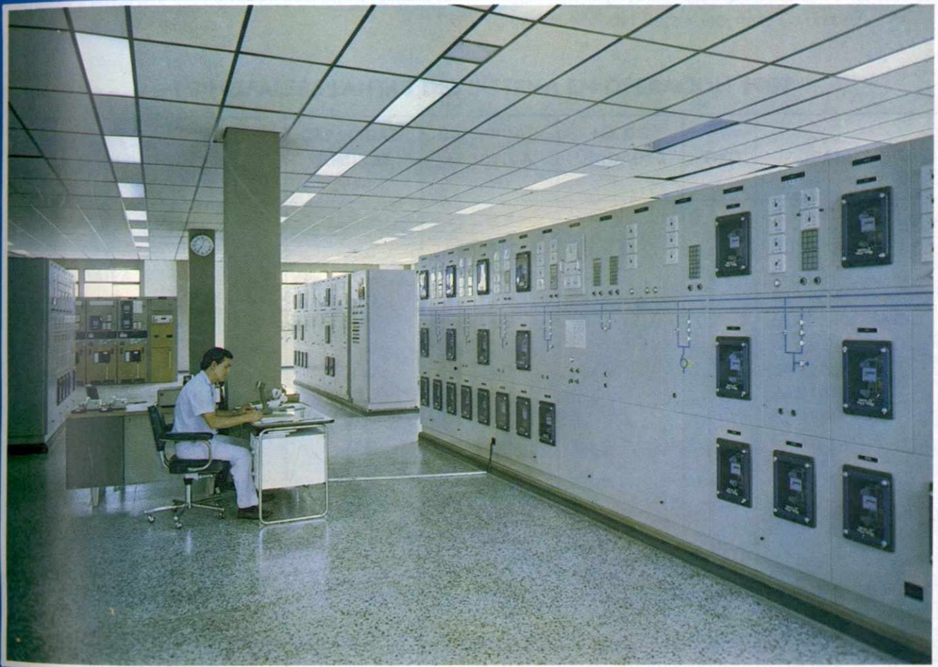
SUBESTACION SAN BERNARDINO.- SALA DE CONTROL.- (POPAYAN)
