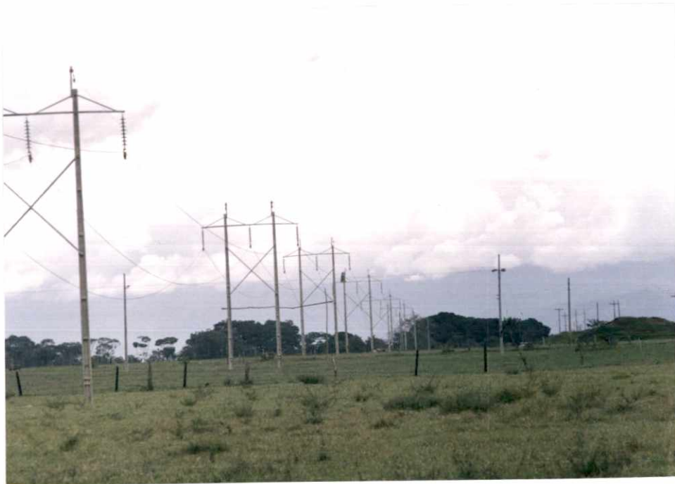
CONDUCTORES Y CABLE DE GUARDIA SOBRE POLEAS LISTO PARA EL PROCESO DE TENSIONADO
