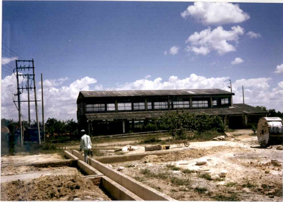
OBRAS CIVILES EN LOS PATIOS DE LA NUEVA S/E. AL FONDO LA CASA DE MAQUINAS DIESEL QUE ACTUALMENTE ALIMENTAN DE ENERGIA AL MUNICIPIO DE PUERTO LOPEZ.
