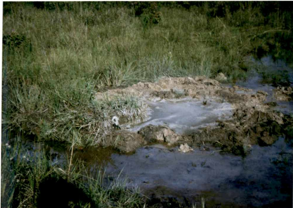
ESTADO DE LOS ANCLAJES DE TEMPLETES EN TERRENOS FANGOSOS
