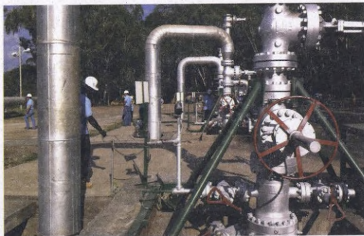
Línea de conducción y cabeza de pozo en campo geotérmico en El Salvador 11 .
