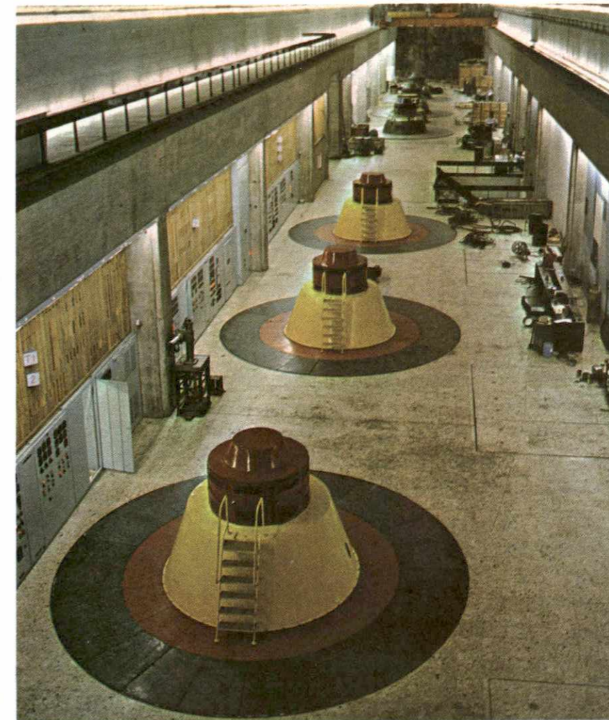
Casa de Máquinas de la Central Hidroeléctrica de Guatapé. Capacidad instalada 560.000 kilovatios (Fotografía Empresas Públicas de Medellín).
