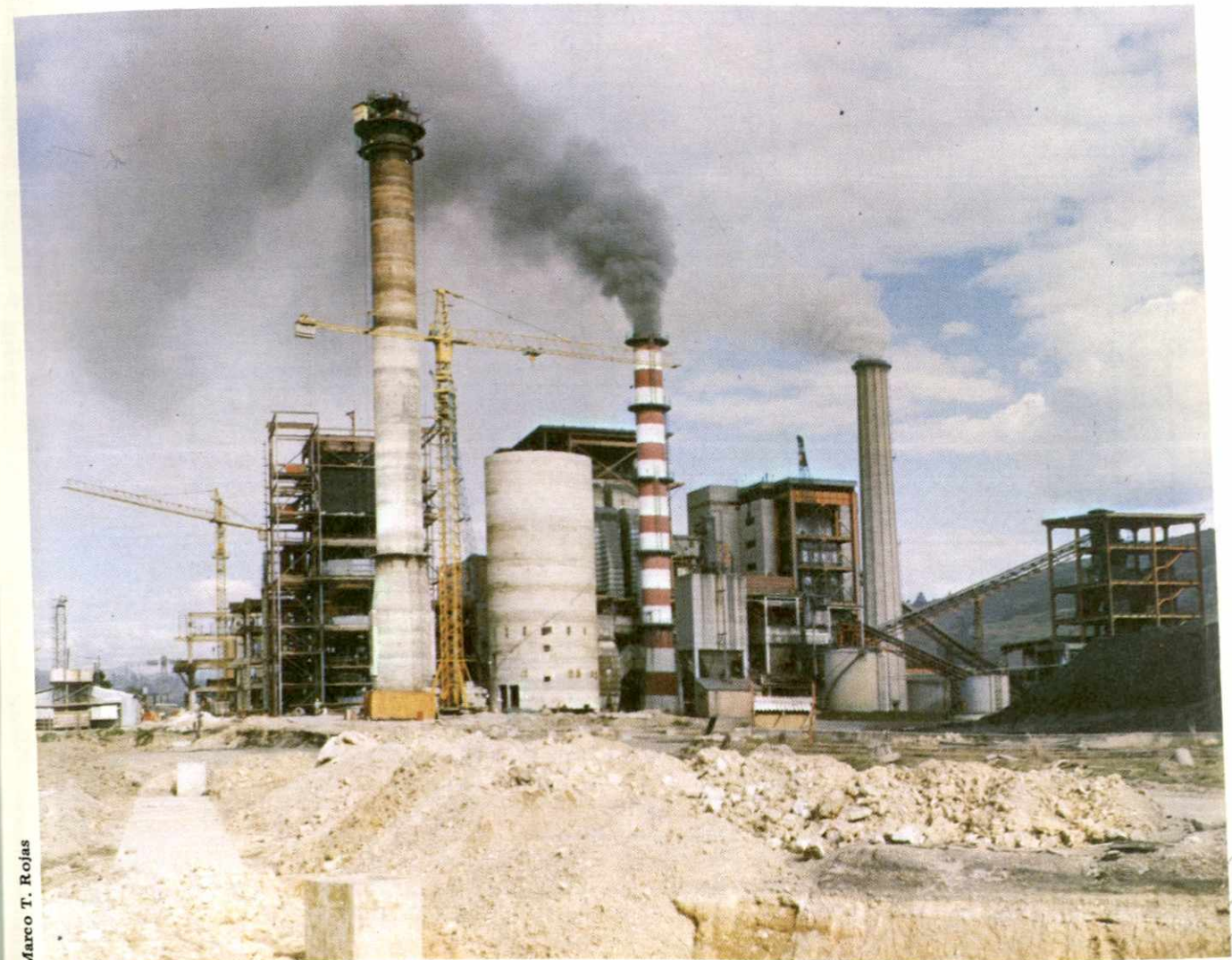
Construcción y montaje de la Tercera Unidad de 66 MW en la Central Termoeléctrica de Paipa.
