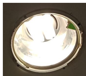
Luminaria tipo bala con dos bombillos fluorescentes compactos (potencia sin identificar)
