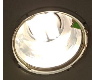
Luminaria tipo bala con dos bombillos fluorescentes compactos (potencia sin identificar)
