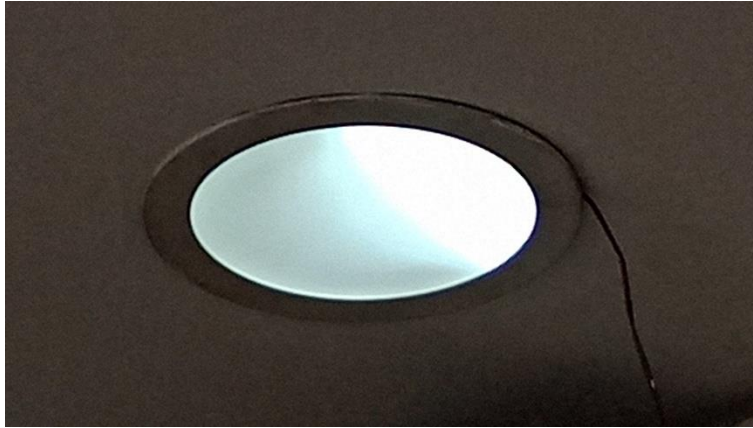
Ilustración 78 Panel Circular LED con fallas. Fuente: Elaboración Propia.
